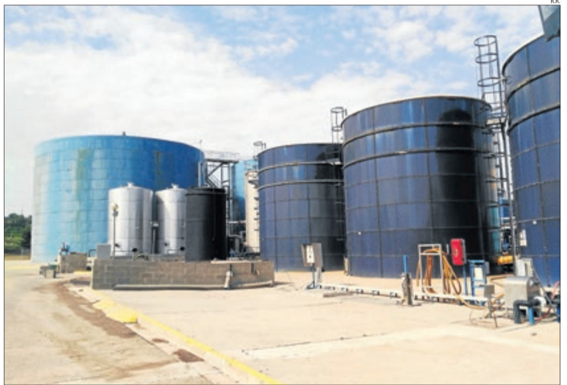
Imatge d'arxiu de la planta de purins de Tracjusa, a Juneda.
